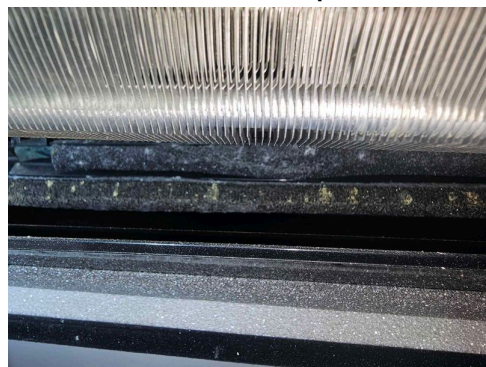
Bac à condensats, Avant / Après
